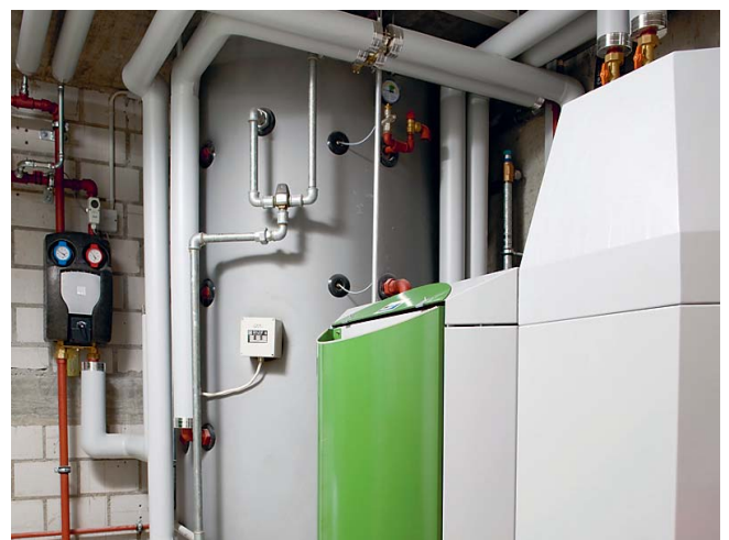
Pelletkessel im Einfamilienhaus Reist
